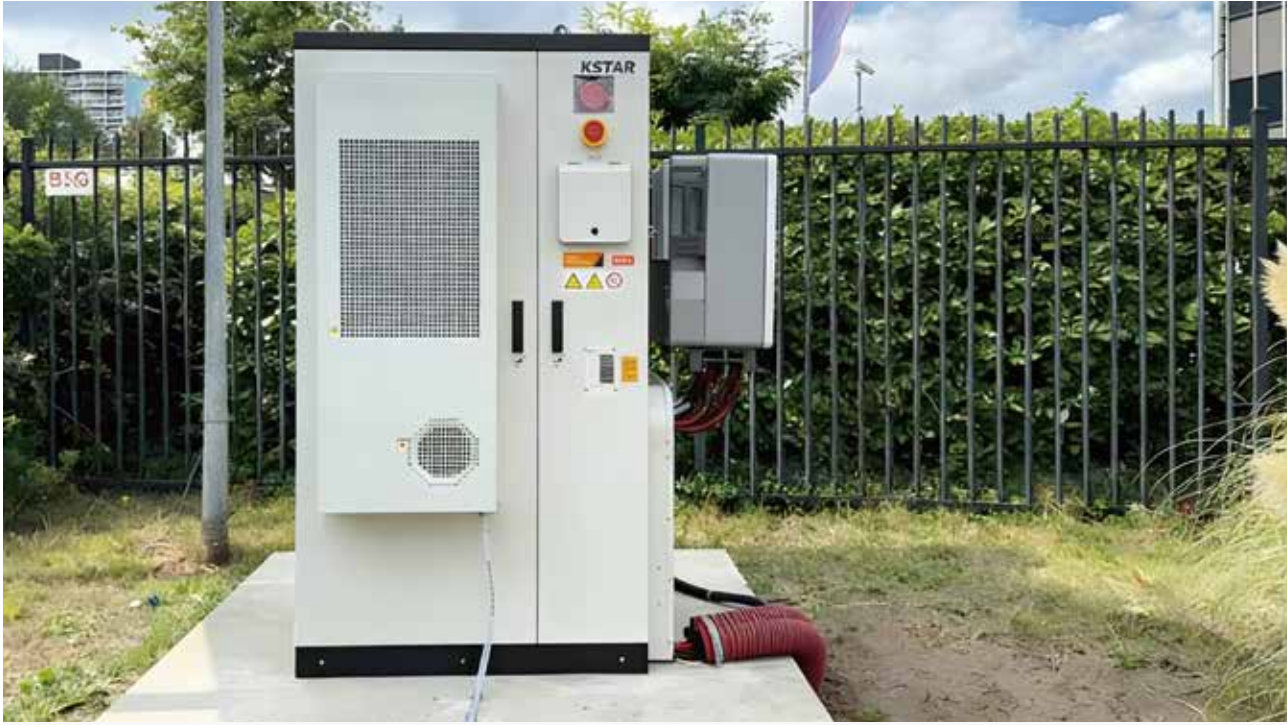
04 Projet C&I de stockage d'énergie (ESS) aux Pays-Bas
