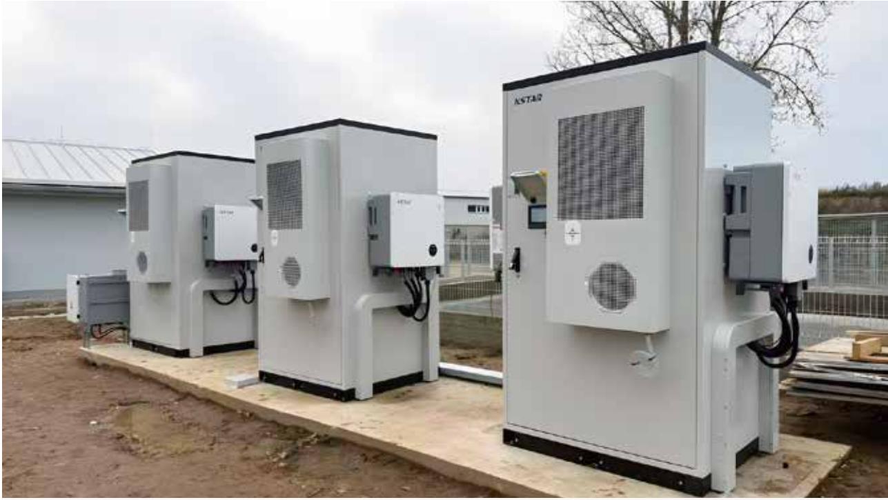
05 Projet C&I de stockage d'énergie (ESS) en République tchèque
