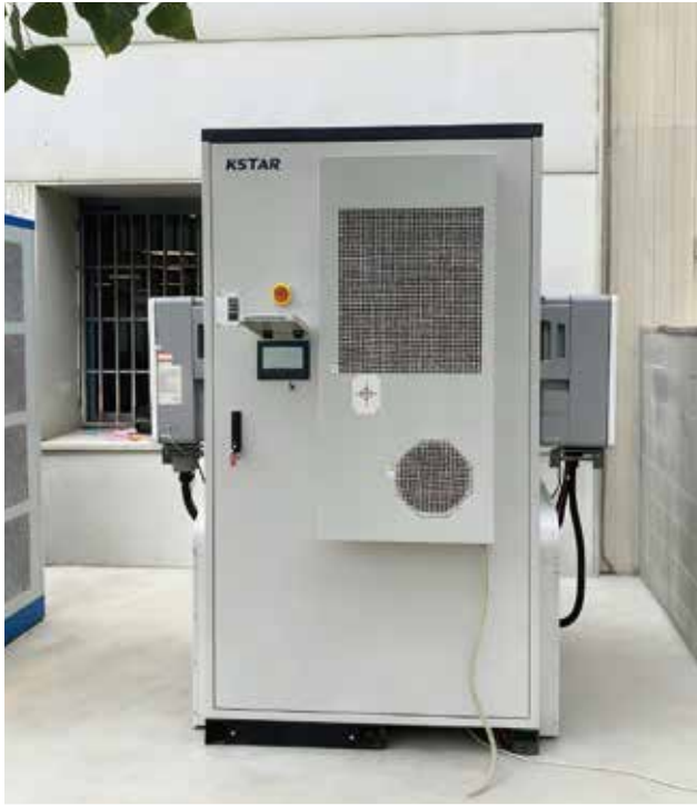
02 Projet C&I de stockage d'énergie (ESS) en Espagne
