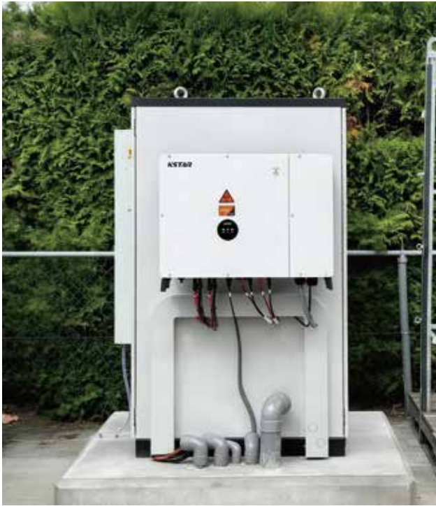
01 Projet C&I de stockage d'énergie (ESS) aux Pays-Bas
